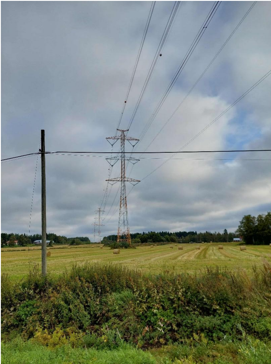
Kuva 13-7. Yhteispylväs reittiosuudella Svartsjö-Ön (C-E), jonka pylväs on maalattu ja ukkosjohtimiin on asennettu pallot lentoliikenteen huomiomerkinnöiksi.
