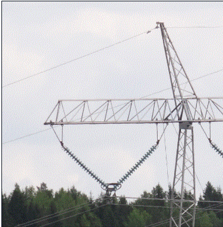
Kuva 5-19. Voimajohtopylvään eristimiä, joissa koronapurkauksia voi esiintyä.
