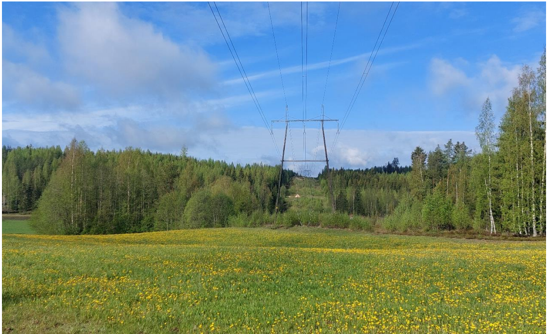
Kuva 72. Nykyinen Vuoksi-Konkapelto voimajohto Mäntylammen itäpuolella Rautjärven kunnassa. Näkymä kuvattu idästä länteen.
