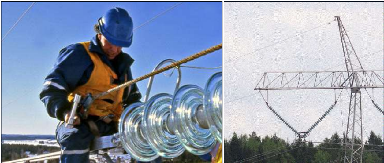
Kuva 61. Voimajohtopylvään eristimiä, joissa koronapurkauksia voi esiintyä.
