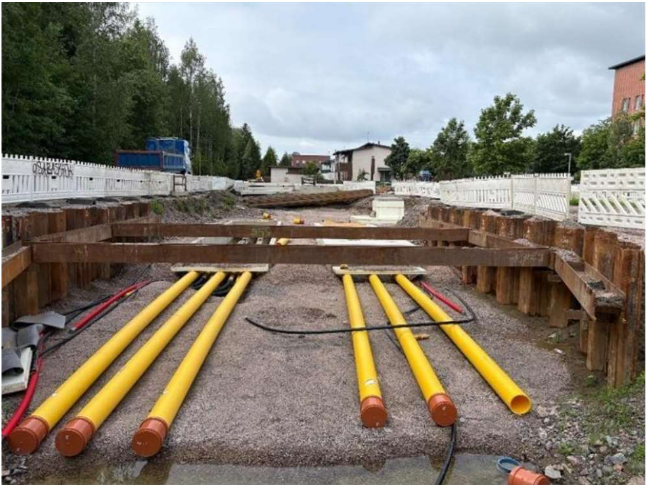
Kuva 16. Kaapeliyhteyden rakentaminen aiheuttaa avojohtojen tapaan maankäytön rajoituksia kasvillisuudelle ja rakennusten sijoittamiselle lähelle lunastettua kaapelialuetta. Maakaapelialueella ei voi myöhemminkään kasvattaa puita, koska niiden juuret saattavat vahingoittaa kaapeleita.
