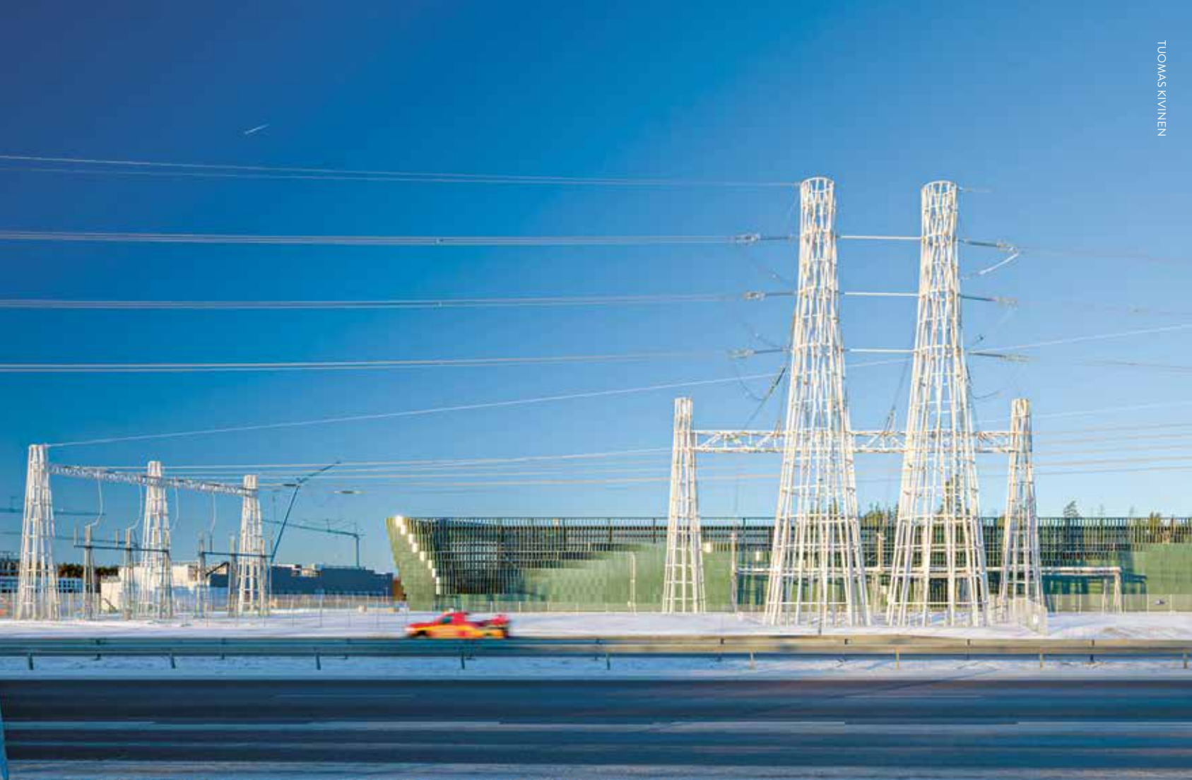
Fingridillä on menossa lähes miljardin euron edestä kantaverkon vahvistamishankkeita Etelä-Suomessa. Kuvassa kantaverkon Hepokorven sähköasema Espoossa.
