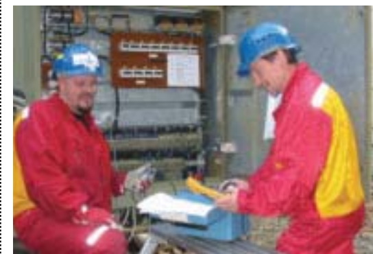
Tehomuuntajan mittaus käynnissä Fingridin Seinäjoen sähköasemalla. Mittaamassa Empower Oy:n Marko Vähäpesola (vas.) ja Reijo Viinamäki.
