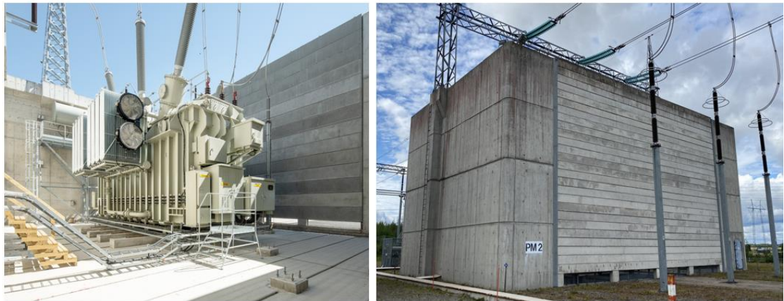
Kuva 4. Muuntaja betonisen suojabunkkerin sisällä (vasemmalla) ja suojabunkkeri ulkoapäin kuvattuna (oikealla) (Fingrid kuva-arkisto).
