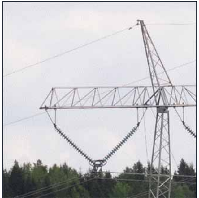
Kuva 89. Voimajohtopylvään eristimiä, joissa koronapurkauksia voi esiintyä.
