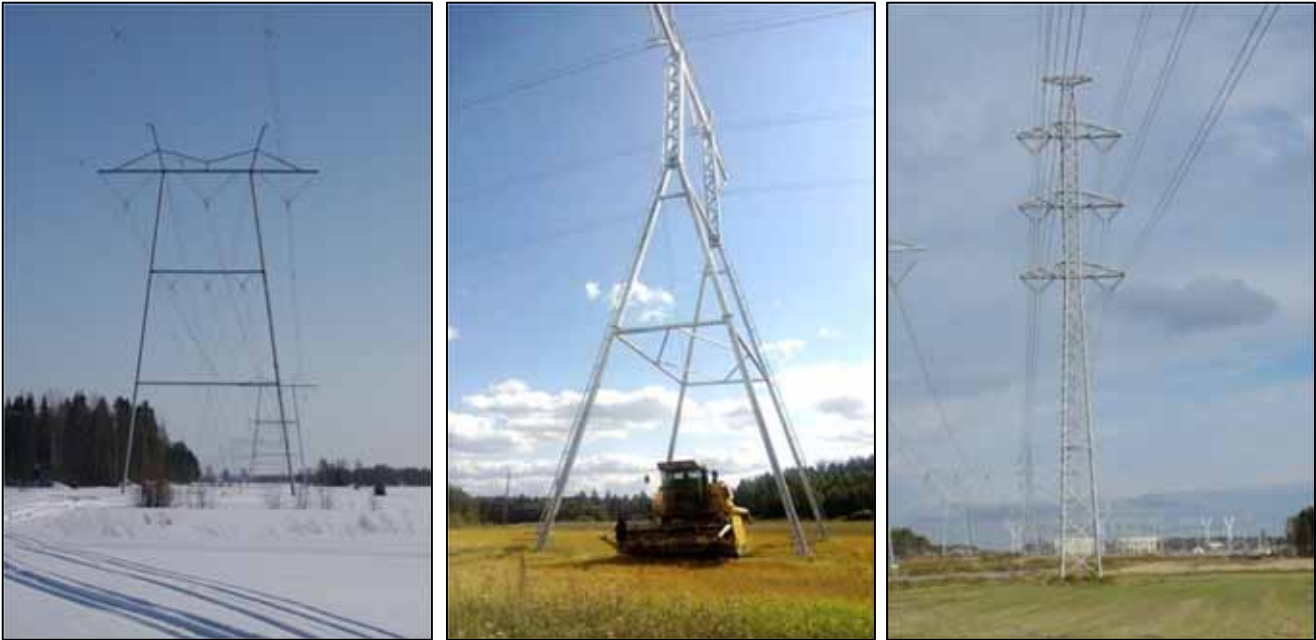
Kuva 26. Esimerkkejä eri pylvästyypeistä. Vasemmalla 400+110 kilovoltin haruksin tuettu teräksestä valmistettu portaalipylväs, keskellä vapaasti seisova harukseton peltopylväs ja oikealla vapaasti seisova t-pylväs.
