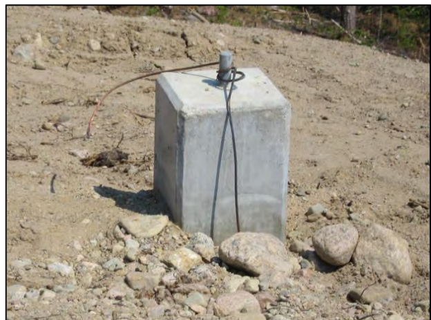
Kuva 9. Pylväsjalan perustus ja maadoituselektrodijohdin.
