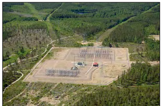
Kuva 31. Esimerkkikuva sähköasemasta. Etualalla on 110 kV ja takana 400 kV kytkinkenttä. Keskellä asema-alueella on muuntaja sekä valvomorakennus.
