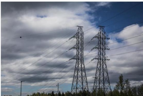
Länsisalmen sähköasema. Fingrid ylläpitää muiden pohjoismaisten kantaverkkoyhtiöiden kanssa säätösähkömarkkinoita. TIINA SOMERPURU
