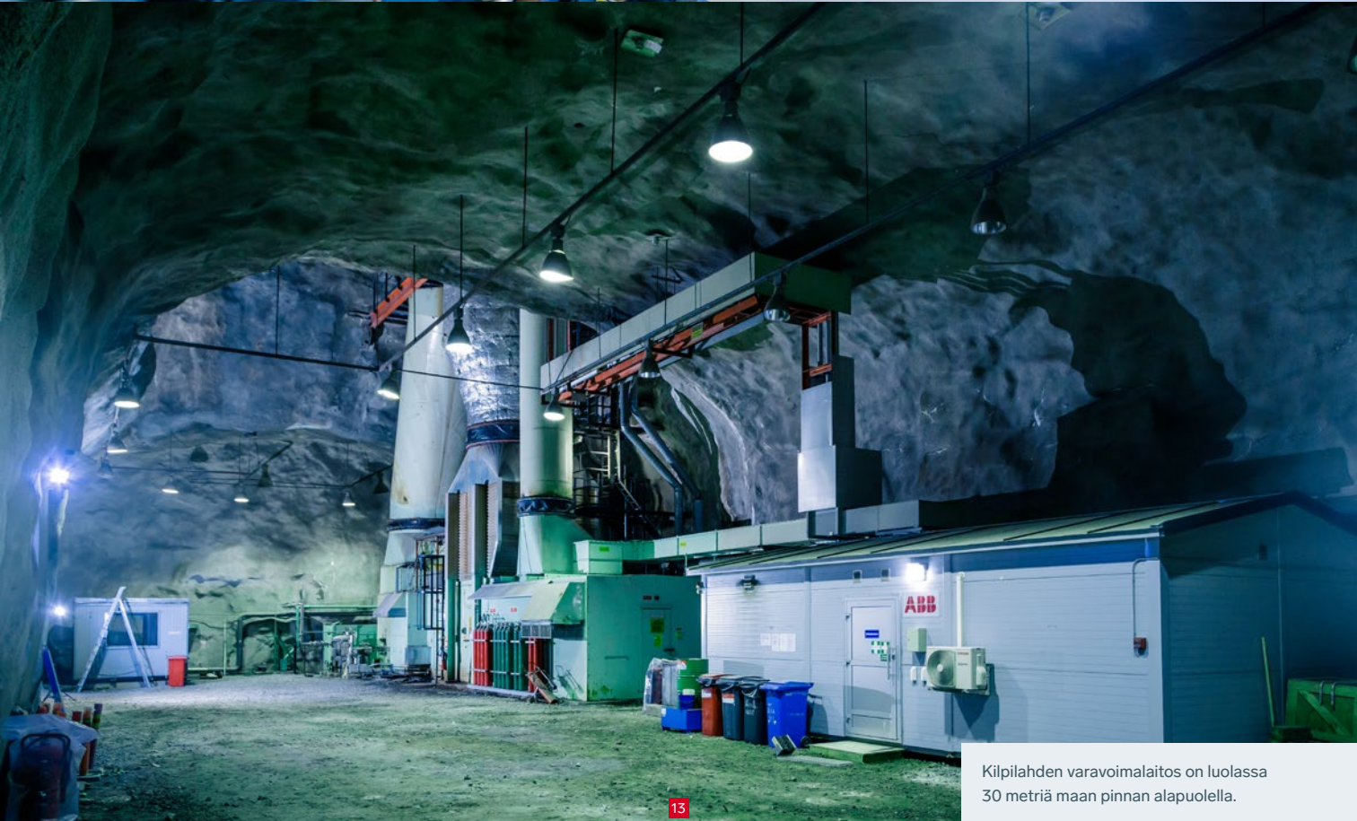
Tolkkisten varavoimalaitoksen generaattorihuone.
