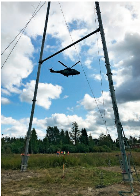
Kaatonut sähkötolppa saatiin pystyyn puolustusvoimien helikopterin avulla.
