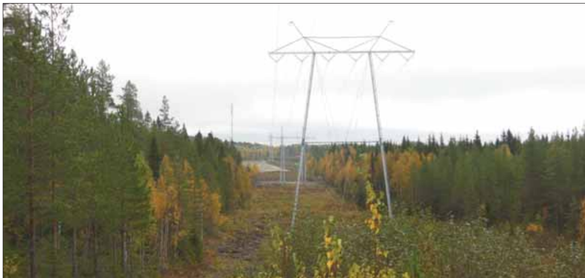
Kuva 4.19. 110 kilovoltin kahden virtapiirin harustettu portaalipylväs, jossa virtapiirit ovat samassa tasossa.
