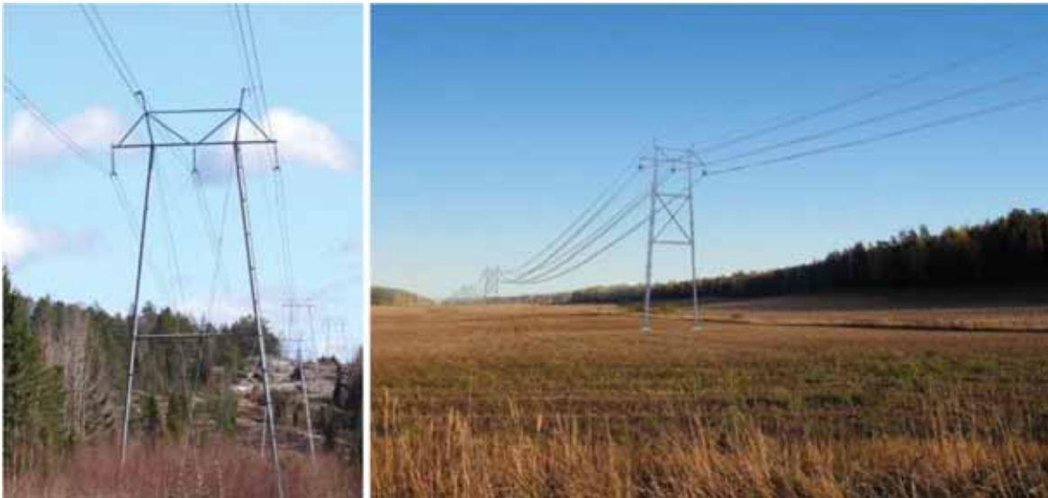
Kuva 4.18. 110 kilovoltin pylvästyyppejä. Vasemmalla harustettu portaalipylväs (peruspylvästyppi) ja oikealla harustamaton peltopylvästyppi.
