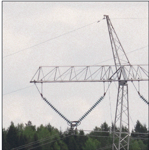
Kuva 9.7. Voimajohtopylvään eristimiä, joissa koronapurkauksia voi esiintyä.
