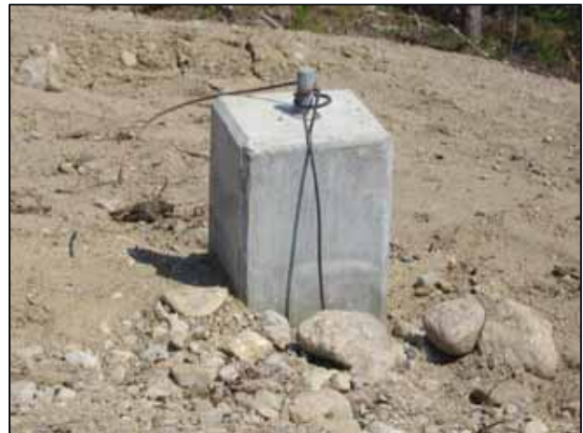
Kuva 3.6. Pylväsjalan perustus ja maadoituselektrodijohdin.
