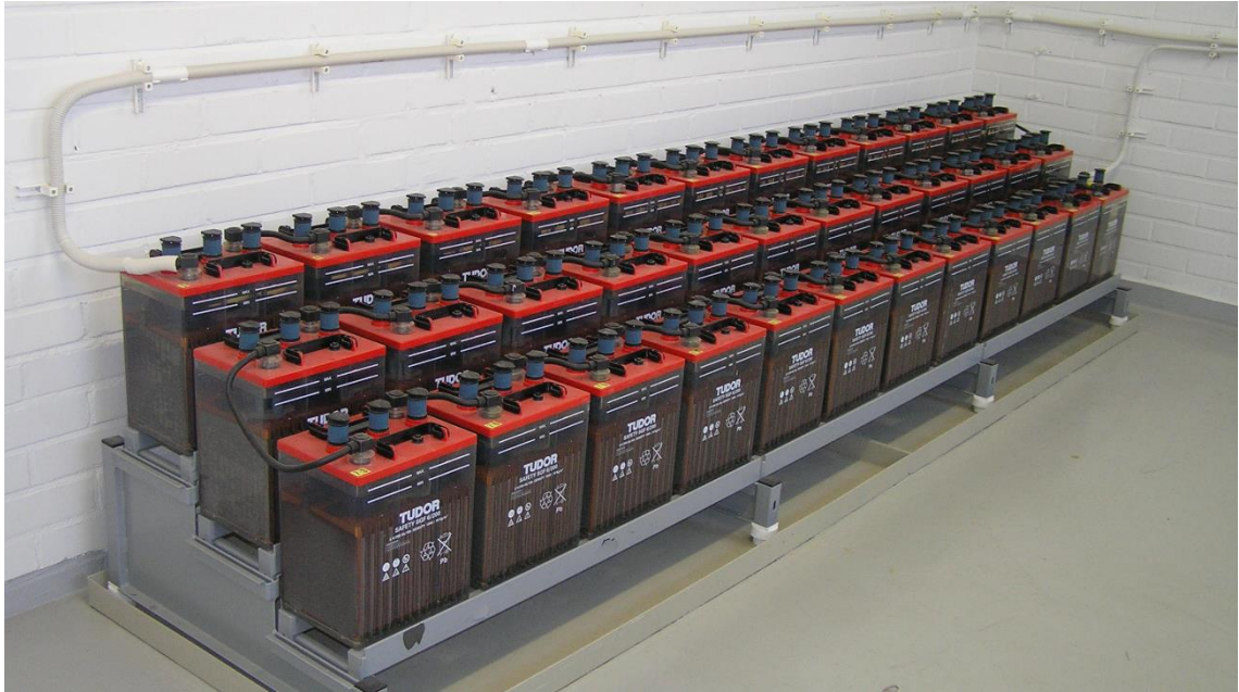
Kuva 2. Erään sähköaseman 3-riviselle yksikerrostelineelle asennettu 110 V:n avoin akusto. Akusto on koottu 36:sta 200 Ah:n ja 6 V:n ryhmäakuista, joista yksi on vajaa-kennoinen. [12]
