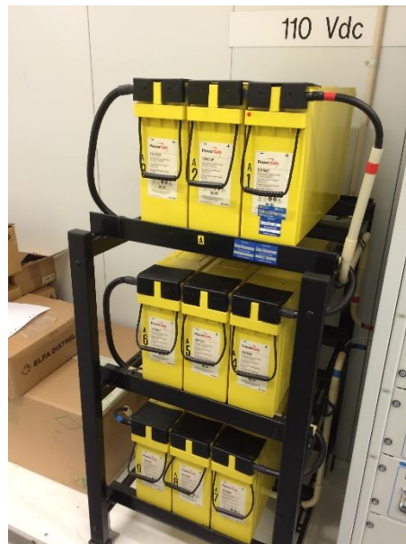
Kuva 5. 110 V:n suljettu lyijyakusto kolmikerrostelineessä [12].
