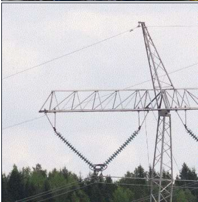
Kuva 9.4. Voimajohtopylvään eristimiä, joissa koronapurkauksia voi esiintyä.
