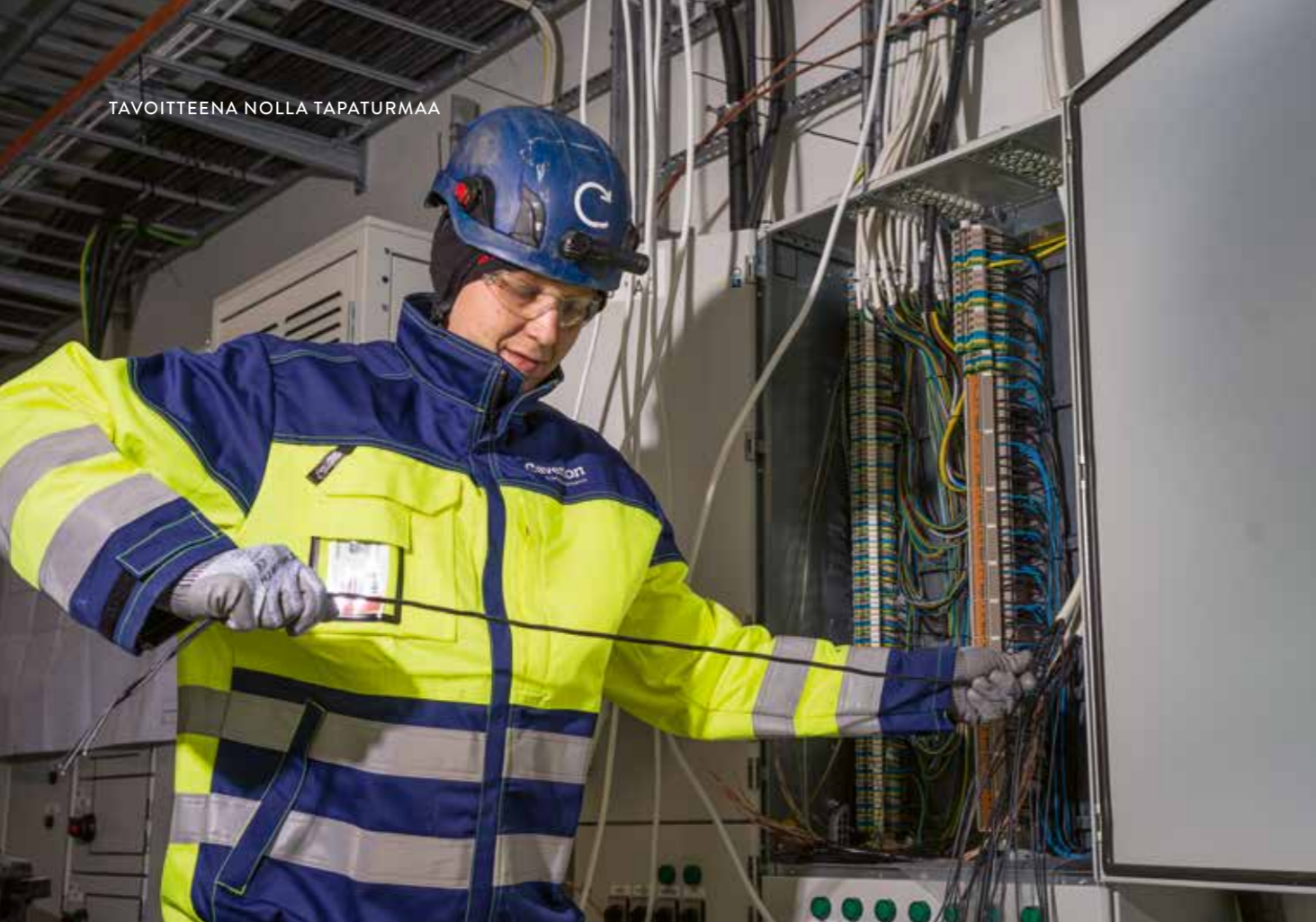
Valkeuden sähköaseman työmaalla täytettiin viime vuonna kaikki Fingridin asettamat ennakoivan turvallisuuden tavoitteet.
