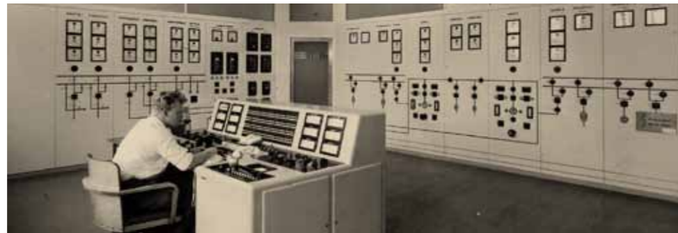
1950-luvulla kaikilla muuntoasemilla oli kolmivuoropäivystys. Kuvassa Petäjäveden sähköasema 1959.
