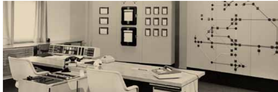
1960-luvulla muuntoasemilla siirryttiin päivävuoroon ja varallaoloon. Tammiston perustettiin käyttökeskus. Tammiston keskusvalvomo uusitus asussa 1969.
