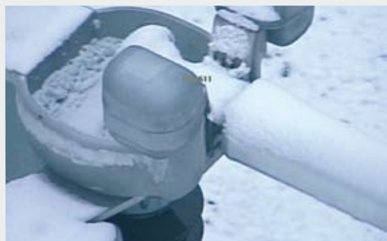
Kameran kuva on tarkennettu saman erottimen yhden vaiheen koskettimiin.
