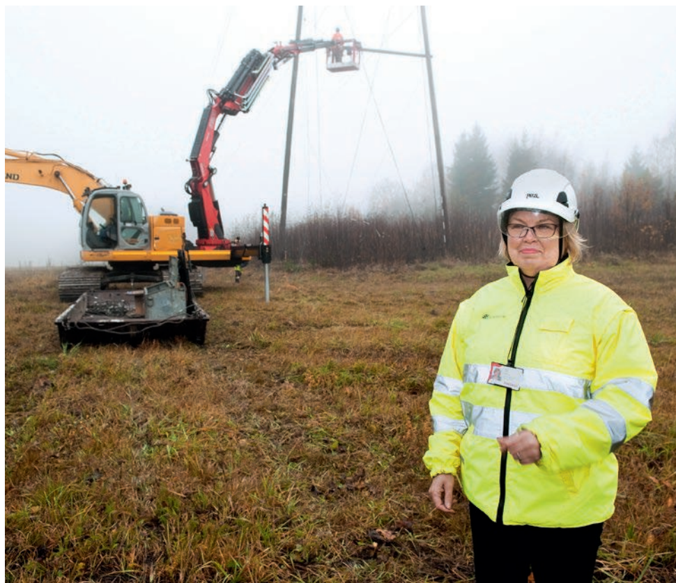
Imatra–Lempiälä-välillä on purettu vanhaa 110 kilovoltin voimajohtoa. Tänä syksynä käynnissä on pylväiden kasaus ja sen jälkeen pystytys, kertoo vanhempi projektipäällikkö Ritva Laine.
