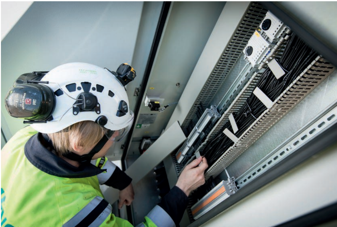
Fingridin Olkiluodon sähköasemapalo kesällä aiheutti sähköpulan uhan, mutta ei johtanut sähköpulaan. Vauriot korjattiin nopeasti.
