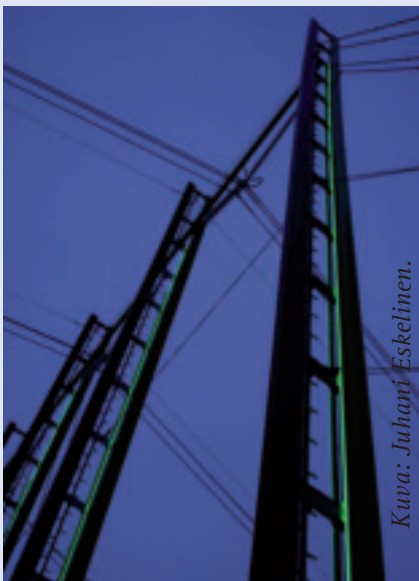
Eurajoen Lapijoelle E8-tien varrelle rakennettu maisemapylväikkö on valaistu LED-valotekniikkaa käyttäen.
