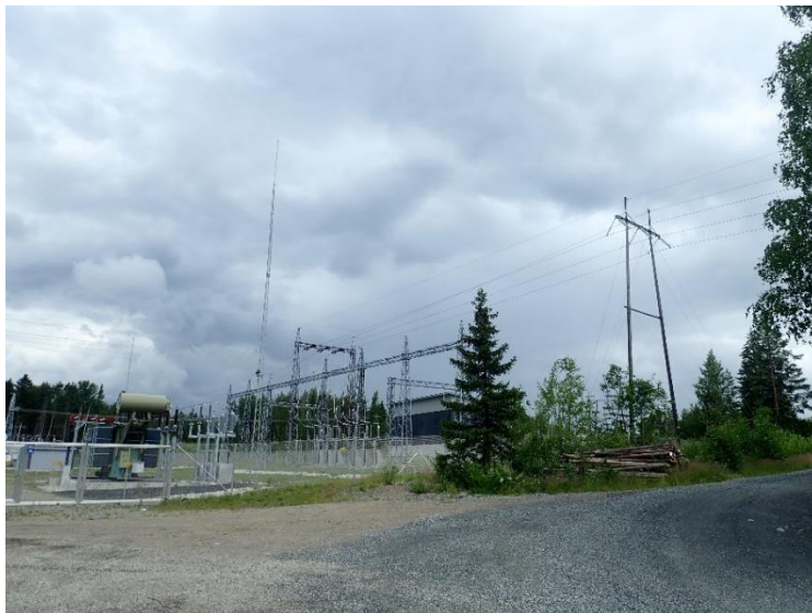
Iisalmen sähköasema. Koilliseen.
